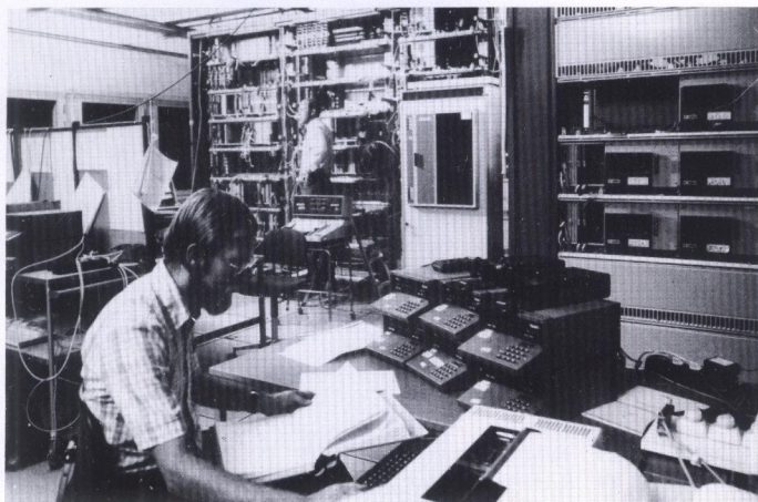
Systemprovning av datanätssystem.
